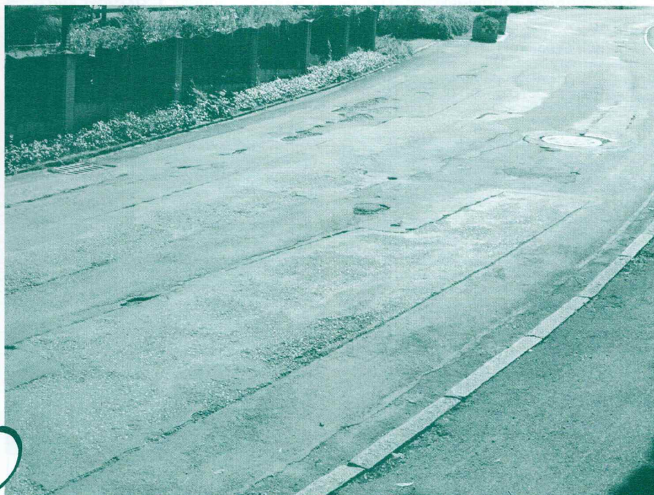
Plattenstrasse: Der Untergrund scheint noch in Ordnung, aber der Belag ist total kaputt. Hier drängt sich in den nächsten Jahren eine Belagserneuerung auf.
