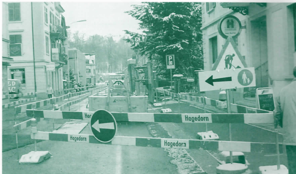
Die Abschränkungen und Beschilderungen an der Bahnhofstrasse lassen keinen Zweifel offen: Die Umbauphase ist in vollem Gange. (Fotos: Esther Weisskopf)
