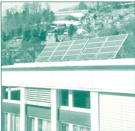
Schulbeispiel: Photovoltaik-Anlage Schulhaus Burg.
