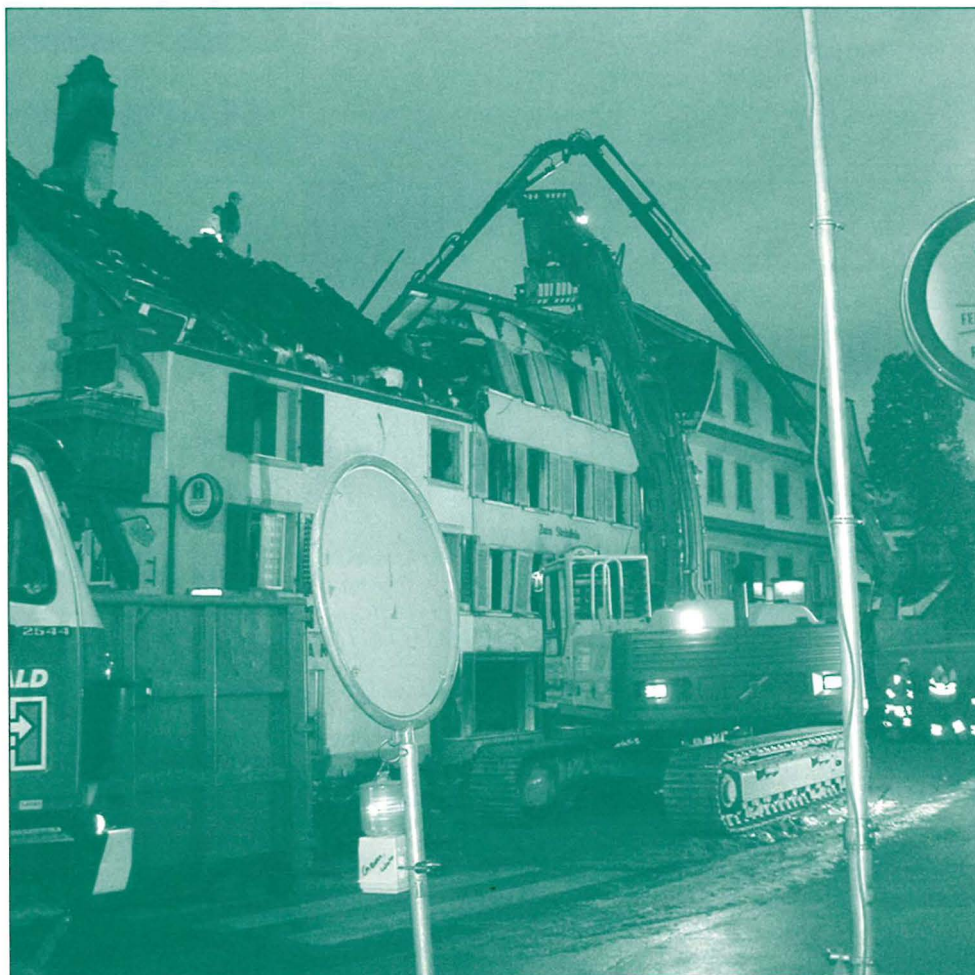
Die Brandursache ist noch nicht geklärt. Sobald das Steinfels-Haus ganz abgerissen wird, machen sich die Brandermittler erneut an die Arbeit, um herauszufinden, warum das Feuer ausbrach.
