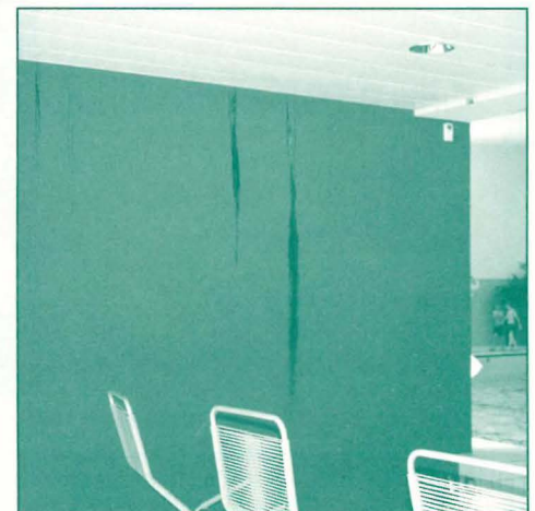
... auf den zweiten Blick werden die Baumängel offensichtlich.
