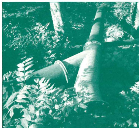
Druckleitungen vom Stampfweier und Lochbach zum Kraftwerk Neuthal.
