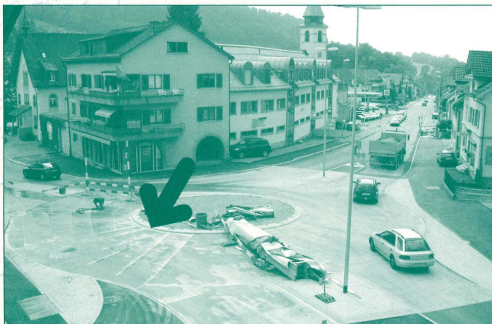
Das Teilstück des Kreisels im Vordergrund (Pfeil) musste ersetzt werden. (Foto: Max Krieg)
