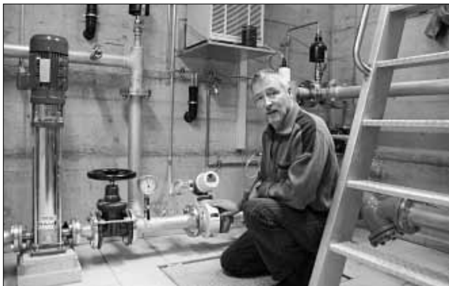
Im tiefen Keller: Pumpstation Hittenberg. Martin Tenüd, während 20 Jahren Präsident der Wasserversorgung oben auf dem Berg, freut sich über die topmoderne Anlage. (Foto: Karo Störchlin)
