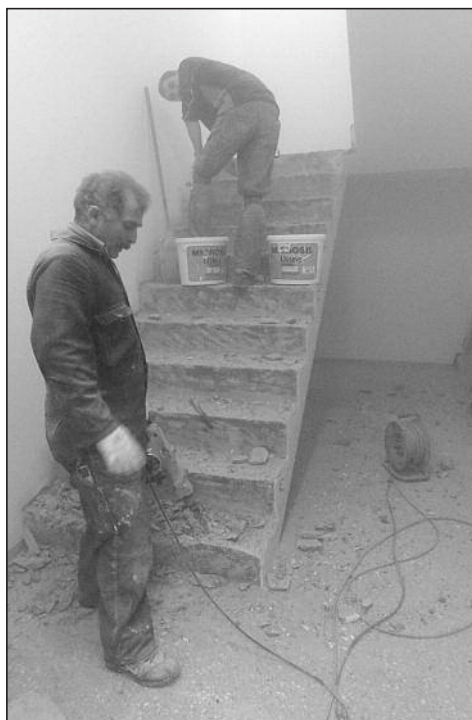
Kaum gebaut, schon sanierungsbedürftig: Von Staub umwölktes Treppenhaus.
