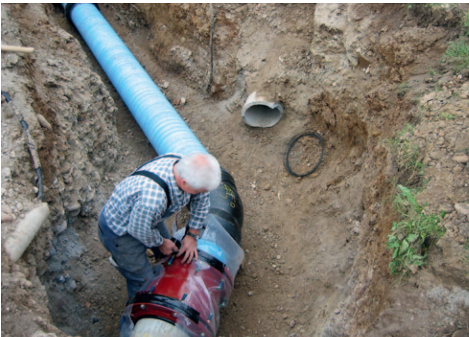
Vor 200 Jahren waren es sogenannte Teuchel, hölzerne und später tönerner Wasserleitungsröhren. Heute werden im Leitungsbau hochwertige Materialien und Methoden angewendet. (Foto: ü)
