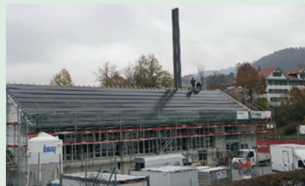
Die EW Wald AG installierte Mitte November auf dem Dach der Turnhalle Burg eine 135 m 2 grosse Photovoltaikanlage. (Foto: zVg)
