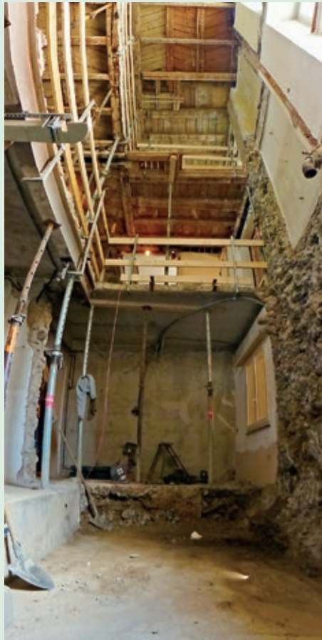
Aktueller Blick in das Gemeindehaus: In dieser Gebäudeöffnung entsteht in den nächsten Wochen der Liftschacht. (Fotos: zVg Gemeinde Wald)
