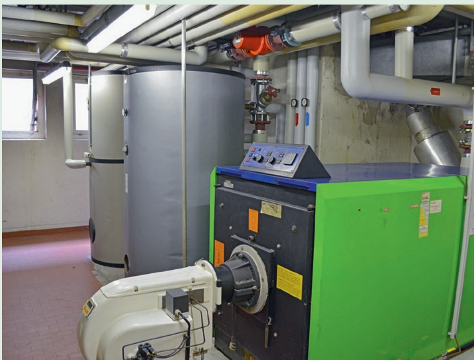
Heizungen sind alle zwei Jahre einer Routinekontrolle zu unterziehen.
