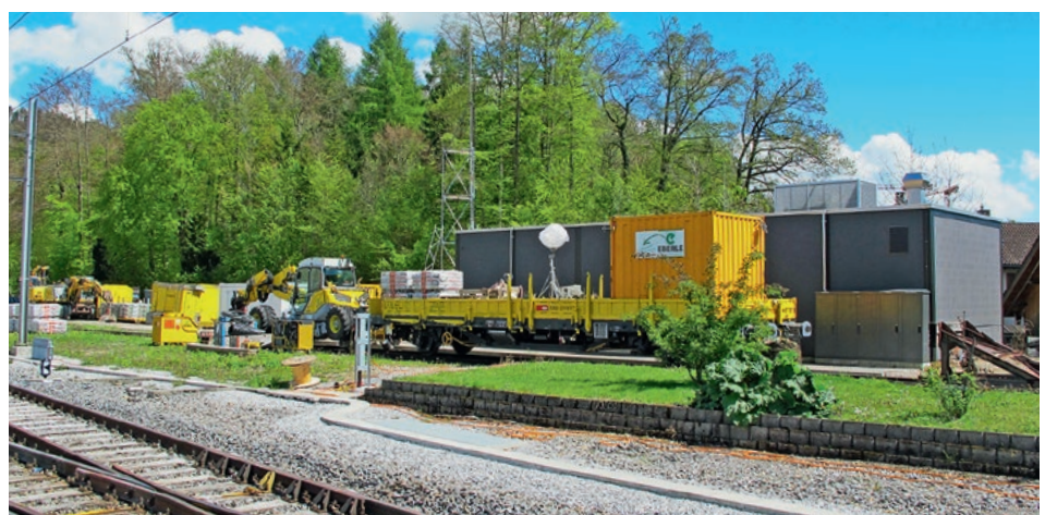
Hinter den Gleisen sind Material und Maschinen für den Bahnhofumbau bereit. Rechts das Stellwerkgebäude.
