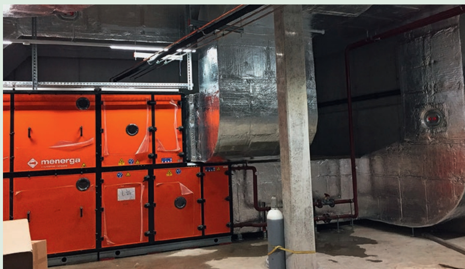
Das Lüftungsgerät im neuen Technikraum des Hallenbads, das am 1. Dezember wiedereröffnet wird. (Foto: zVg)
