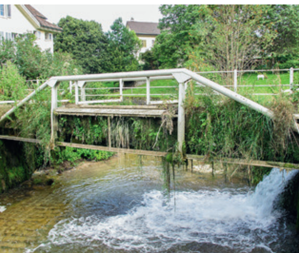
Vom Zahn der Zeit und unerwünschter Vegetation gezeichnet: die alte Kanalbrücke.
