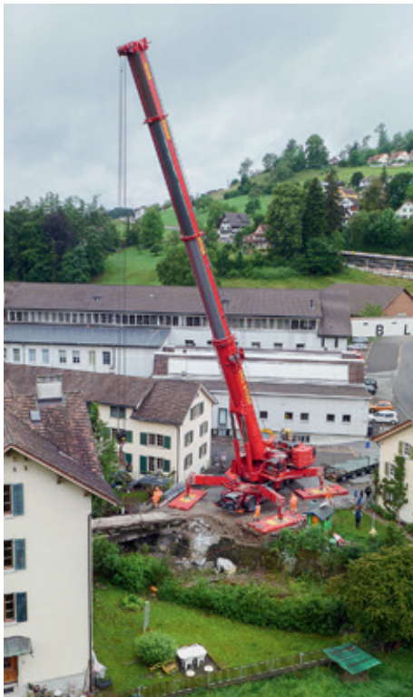
Ein riesiger Pneu- kran hebt Teile der alten Brücke aus der Verankerung. (Foto: Esther Weisskopf)
