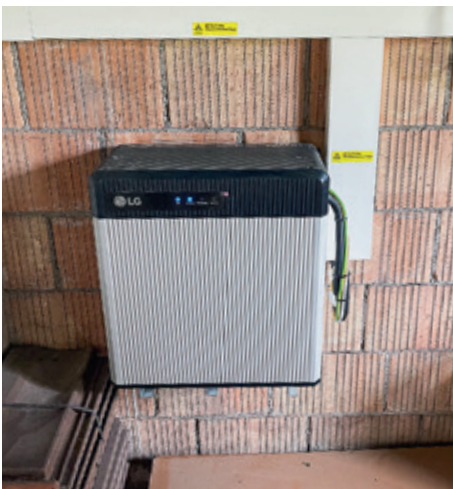
Batteriespeicher 10 kWh, wird demnächst verdoppelt. (Foto: zVg)
