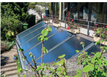
Die Sonnenkollektoren dienen auch als Garagenvordach (Foto: Marcel Sandmeyer)
