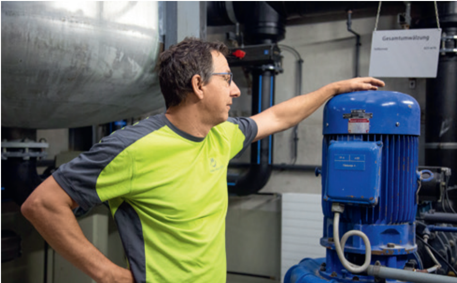
Bademeister René Kindlimann bei der Überprüfung der Pumpe, dem Herzstück der «Badi im Dorf». (Foto: Matthias Hendel)
