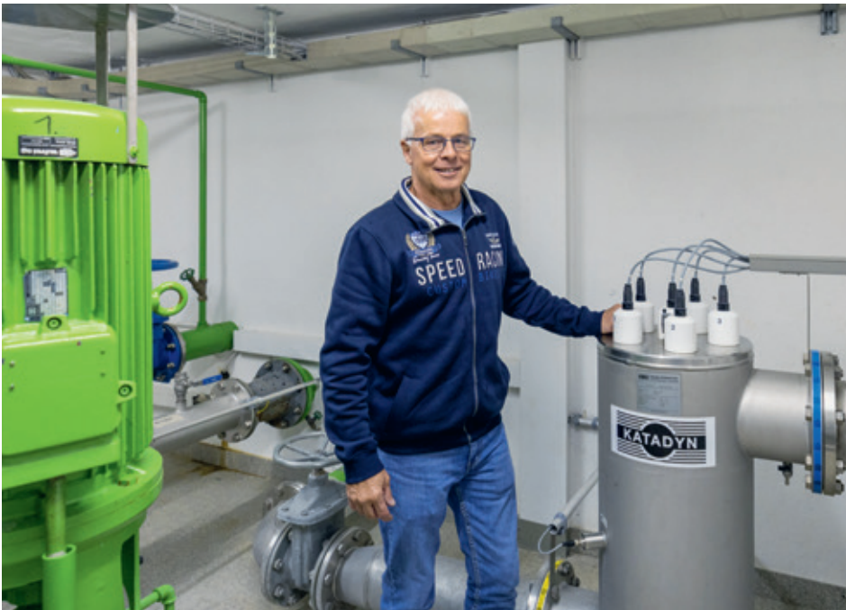
Brunnenmeister Sina im Reservoir neben der UV-Anlage, die das Quellwasser entkeimt und auf Trübungen prüft. (Foto: Janik Honegger)
