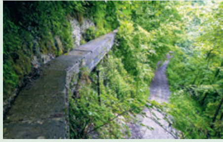
Der beliebte Plättliweg im Sagenraintobel bedarf einer aufwendigen Instandstellung. (Fotos: zVg)
