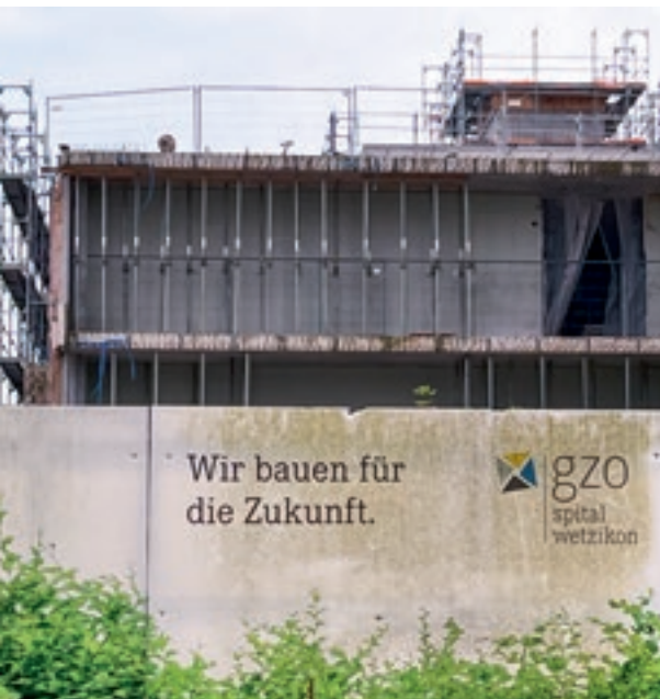
Die Bauarbeiten sind eingestellt. (Foto: Werner Brunner)
